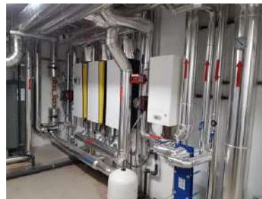
Instalación de geotermia en THB El Cid.
